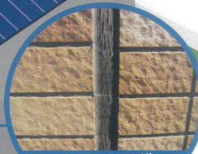
シーリング 劣化
